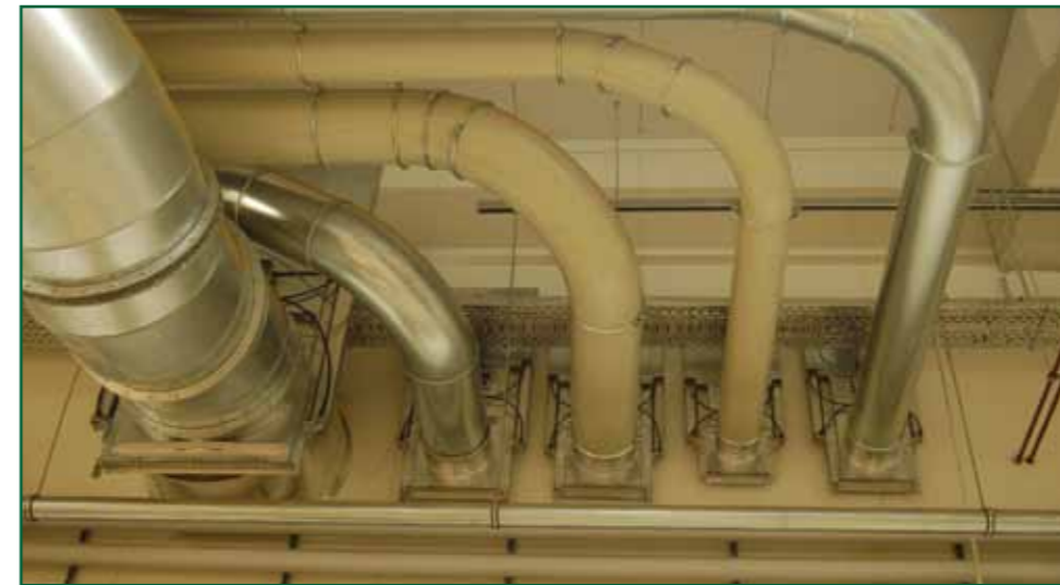
Automatische afsluitkleppen bij de doorvoer in de brandwerende muur. Bij brandalarm worden deze geactiveerd
