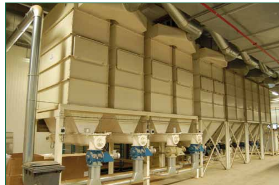
Batterij filterkasten met pulsreiniging met onderin de filterkasten de afvoer van stof via schroeven en rotatiesluizen
