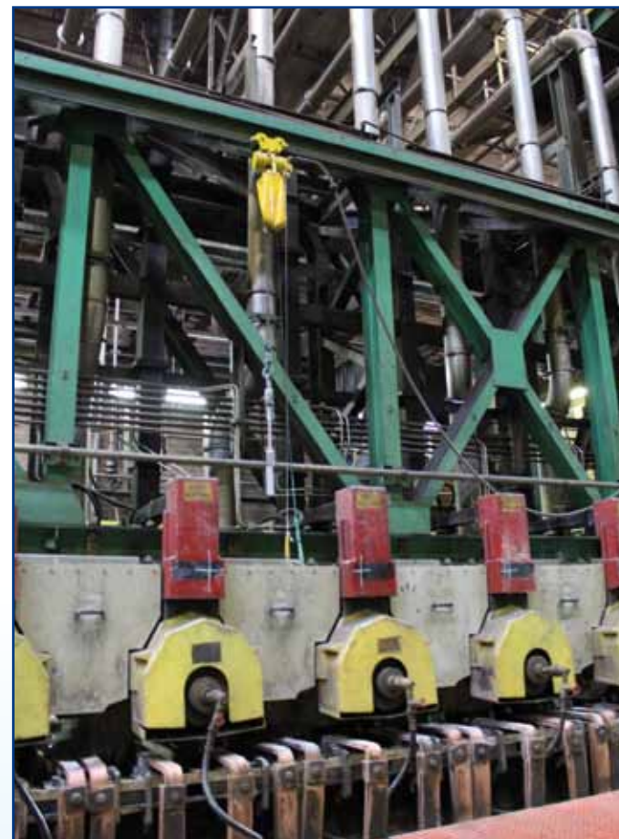
Eén van de drie productielijnen van Corus CPP voor het vertinnen van verpakkingsstaal. Boven de vertinbaden in de productielijnen zijn nieuwe afzuiginstallaties gebouwd, voorzien van afzuigkappen en met afvoerkanaalen naar een zogenoemde natwasser of natfilterinstallatie
